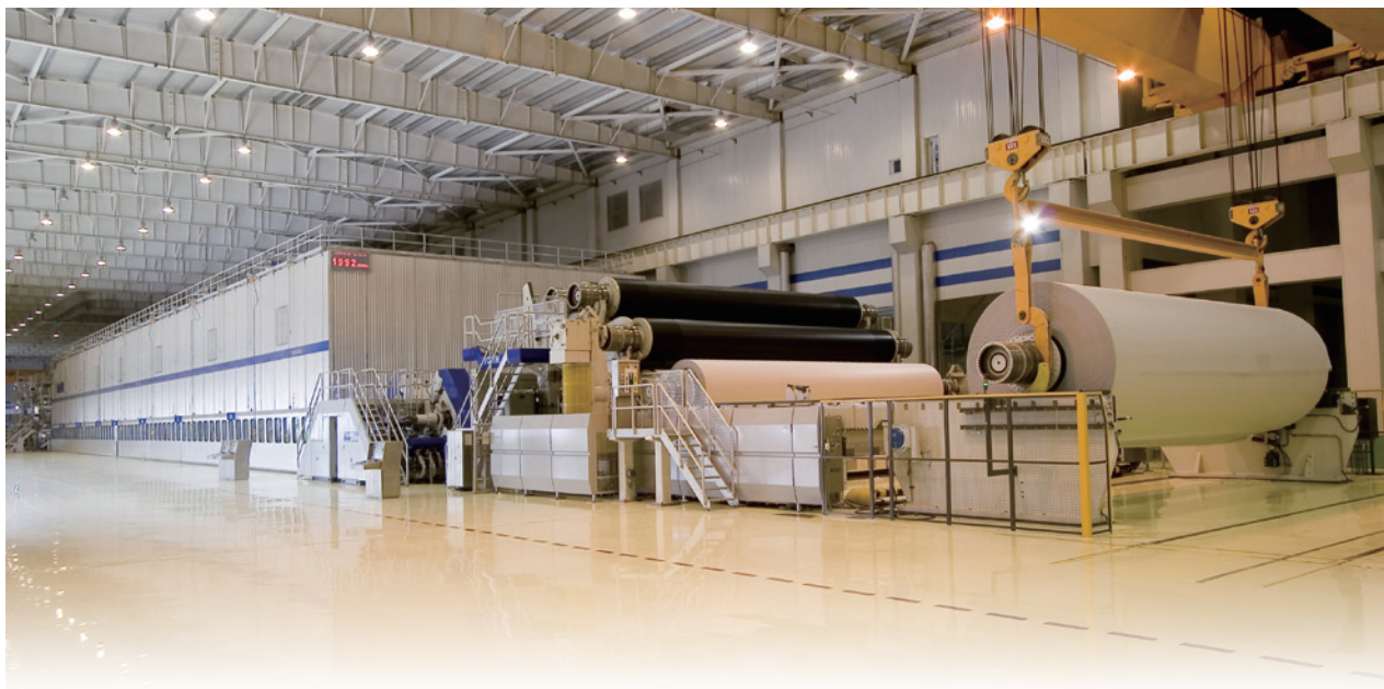
ABB 的传动控制和高效变频电机等技术设备，应用于大型造纸项目，助力企业实现平稳、节能、高效的生产。
